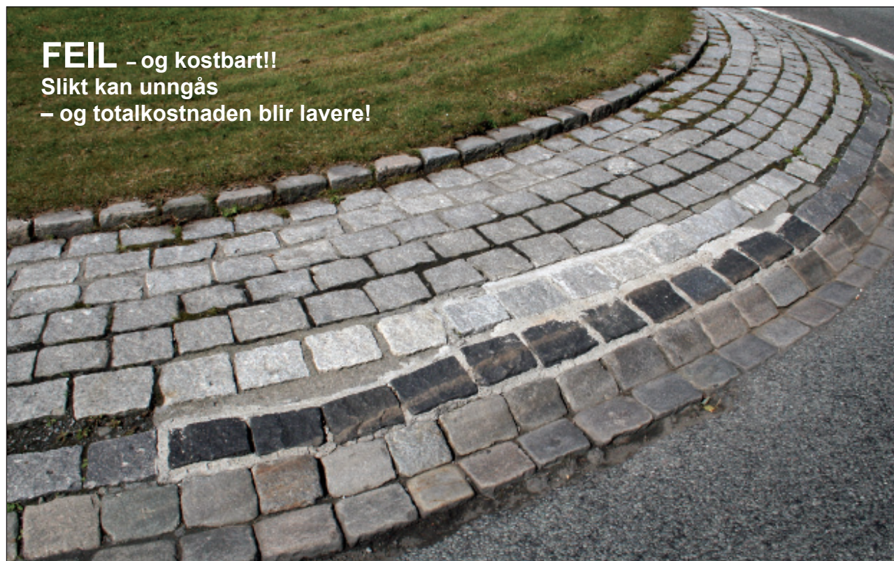
En kostbar installasjon. Allerede reparert to ganger og ødelagt for 3. gang. Ca. 1 1/2 år gammel...
